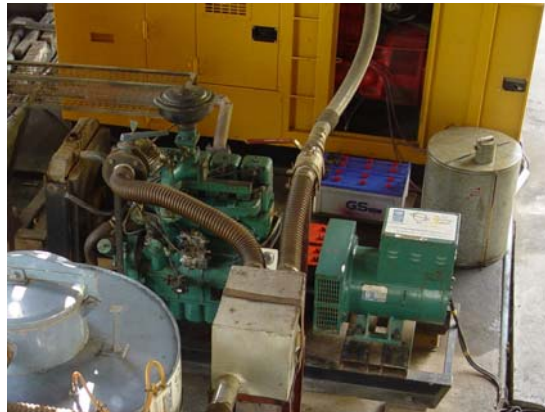
Figure 3: 30 kVA generator set (gas)
